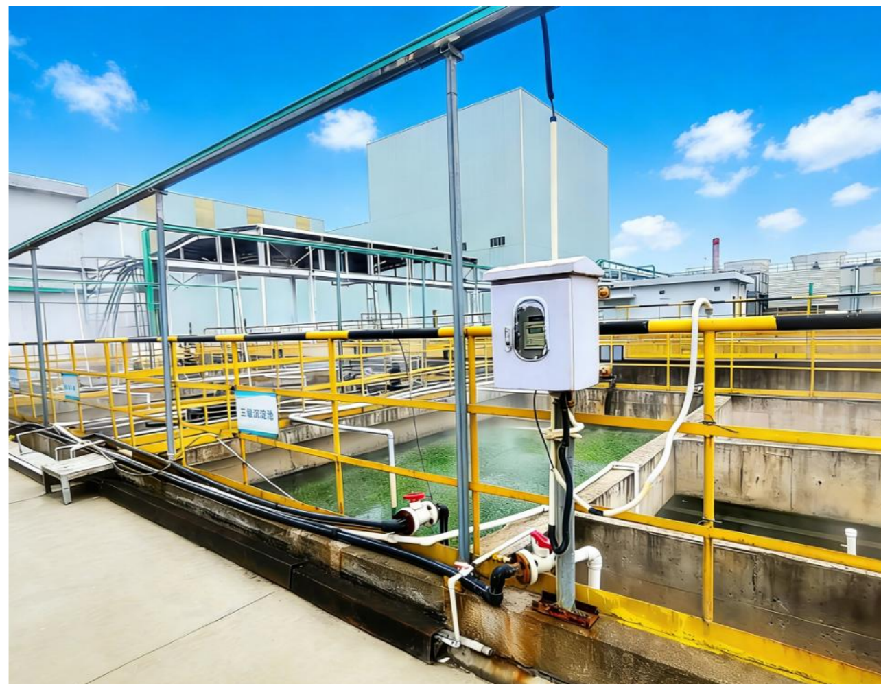
江西中矿锂业一厂污水处理系统
