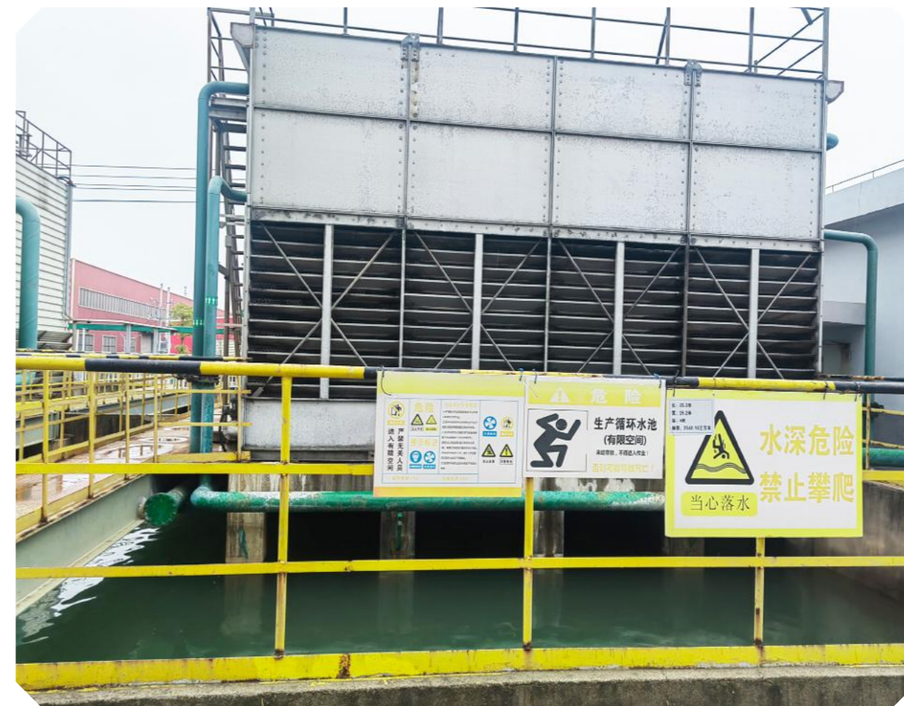
江西中矿锂业循环水设施
