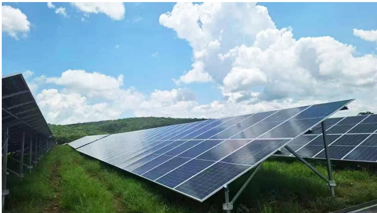
Kitumba 一期 50 兆瓦光伏电站
