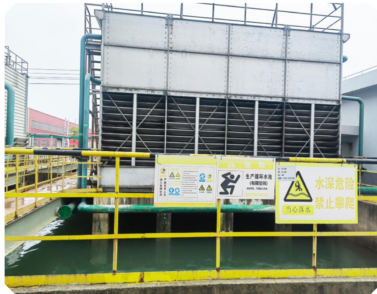
江西中矿锂业循环水设施
